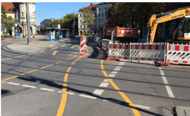
Bei einer Strassenbaustelle am Stiglmaierplatz in München wird ein temporärer Radweg eingerichtet, der deutlich auf dem Boden markiert und mit temporären Einrichtungen vom MIV abgetrennt wird.
